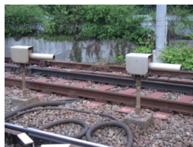
▲踏切支障報知装置
